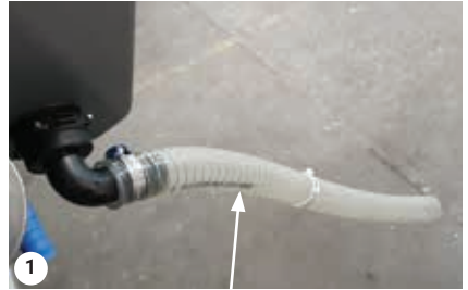
Hadica hladiny vody z nádrže na odpad
