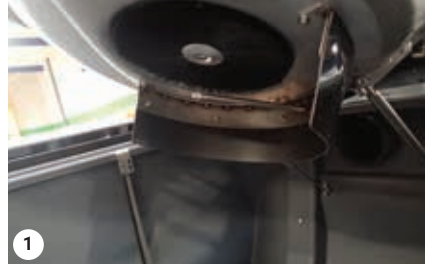
Kontrola rotačného filtra a turbíny
