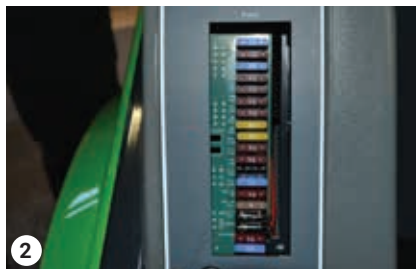
Poistky – pravá strana podlahy kabíny
